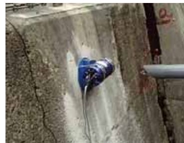
構造物変状観測使用例
